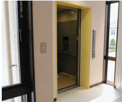
エレベーターを設置することで、2階や3階への行き来がスムーズに。
