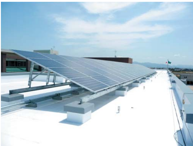
南校舎屋上の太陽光パネルの設置状況
