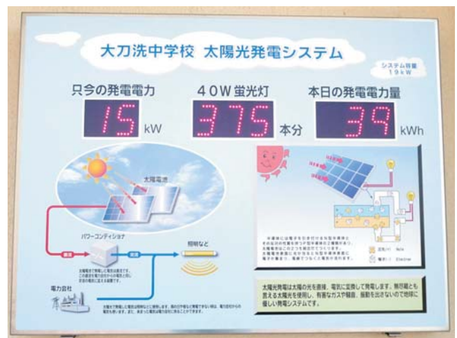
玄関の屋外表示装置の設置状況
