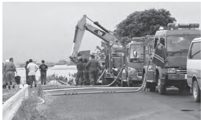
床島地区では消防車による排水が
