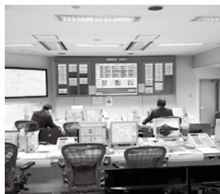
久留米広域消防本部の指令室
