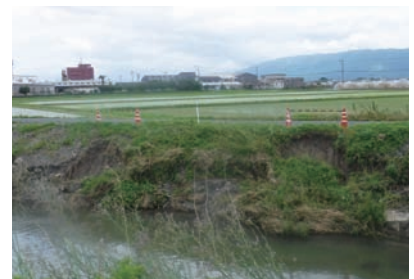
陣屋川 猪本橋上流
