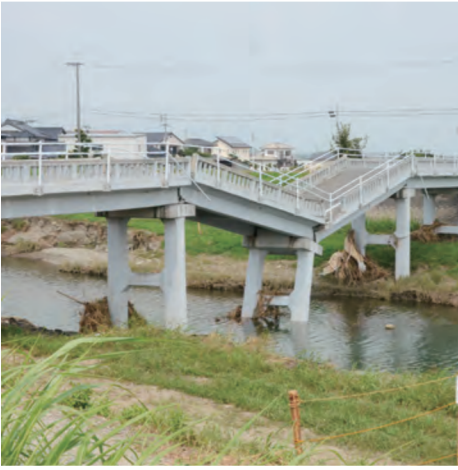
平成30年7月豪雨により被災した、町道
