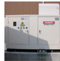
発電設備、燃料タンク
